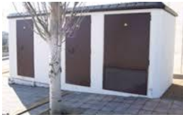
Centro de transformación (CT).
